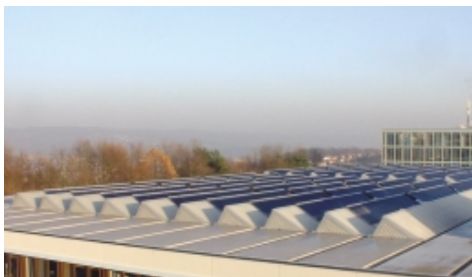
Berkheim bei Stuttgart mit 1330 m 2 die weltweit bisher größte CPC-Vakuum-Röhrenkollektoranlage
