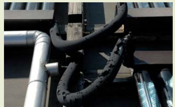
Abb. 30 Was Forscher damals nicht bedachten, Vögel lieben Dämmstoffe für den Nestbau. Foto: TU Chemnitz, Th. Urbaneck
