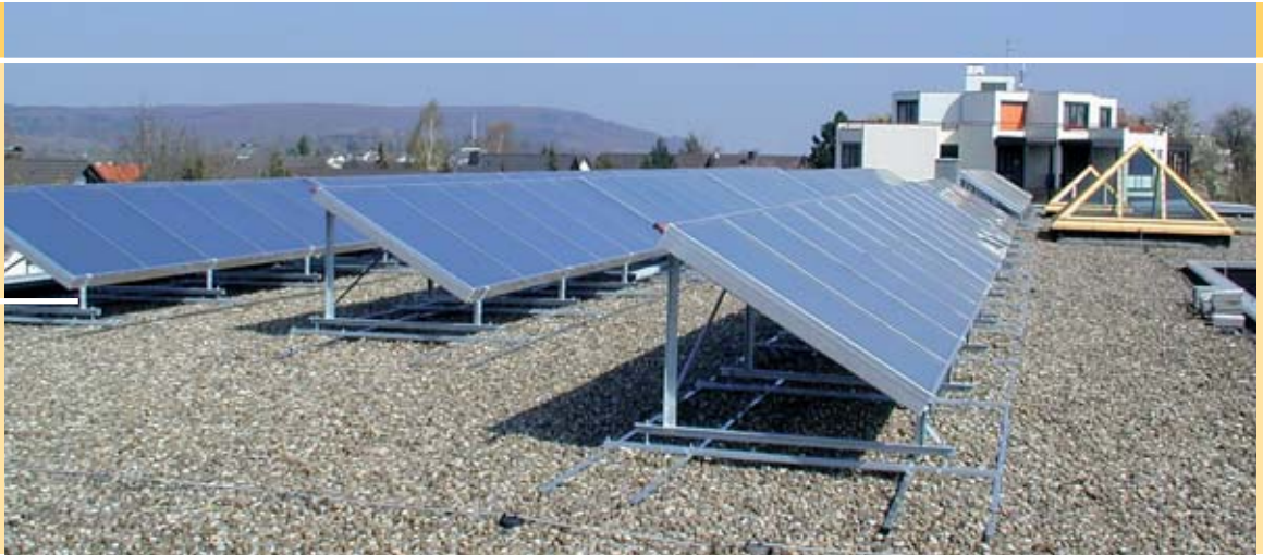
Abb. 11 Blick auf eines der beiden Teilfelder des Kollektorfeldes der Solaranlage Albtherme Waldbronn Foto: Hochschule Offenburg
