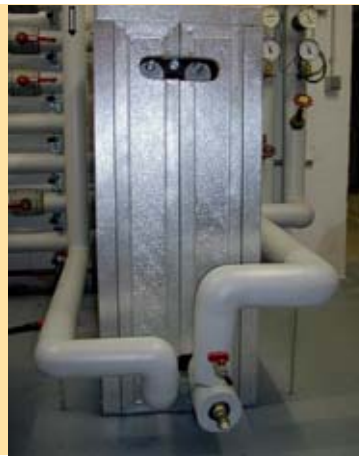
Abb. 5 Pufferspeicher der Solaranlage des Studentendorfs Freiburg Vauban Foto: Hochschule Offenburg
