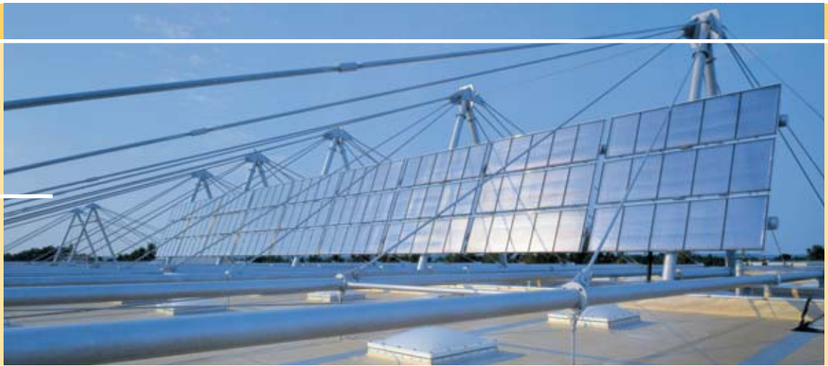
Abb. 19 Kollektor der „Nullemissionsfabrik“ der Fa. Solvis. Foto: Solvis GmbH, C. Richters
