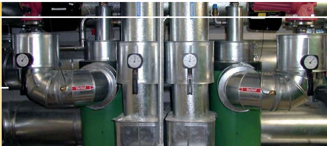
Abb. 4 "Wärmeverteilung mit System" Detailaufnahme aus der Heizzentrale im Hegau Klinikum, Singen. Foto: Hochschule Offenburg
